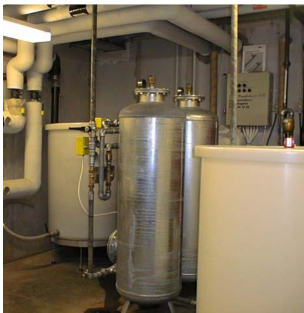
Figur 6.2 Gråvandsanlægget på BO-90. (Billede af E. Eriksson)
