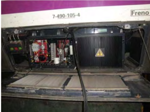
Figura 1-20. Convertidor auxiliar y cargador de batería.
