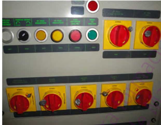
Figura 1-64. Selectores de los equipos de seguridad.
