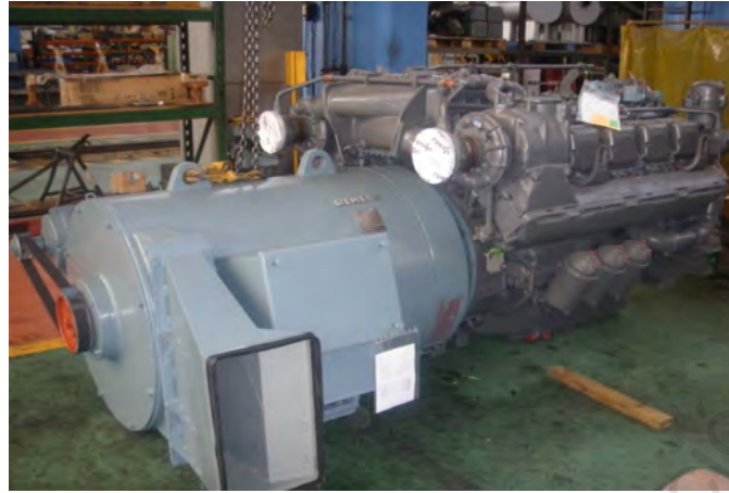
Figura. 3-10 S/311 Motor diésel acoplado con el generador principal
