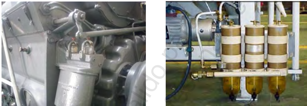
Figura. 3-39 Filtros de impurezas y decantadores de agua
