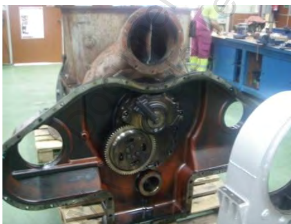
Figura. 3-26 Lado accionamiento del turbo compresor
