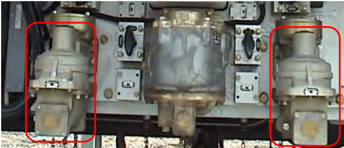
Figura. 5-25 Relés de Freno en Autopropulsados de la S/447 y 598
