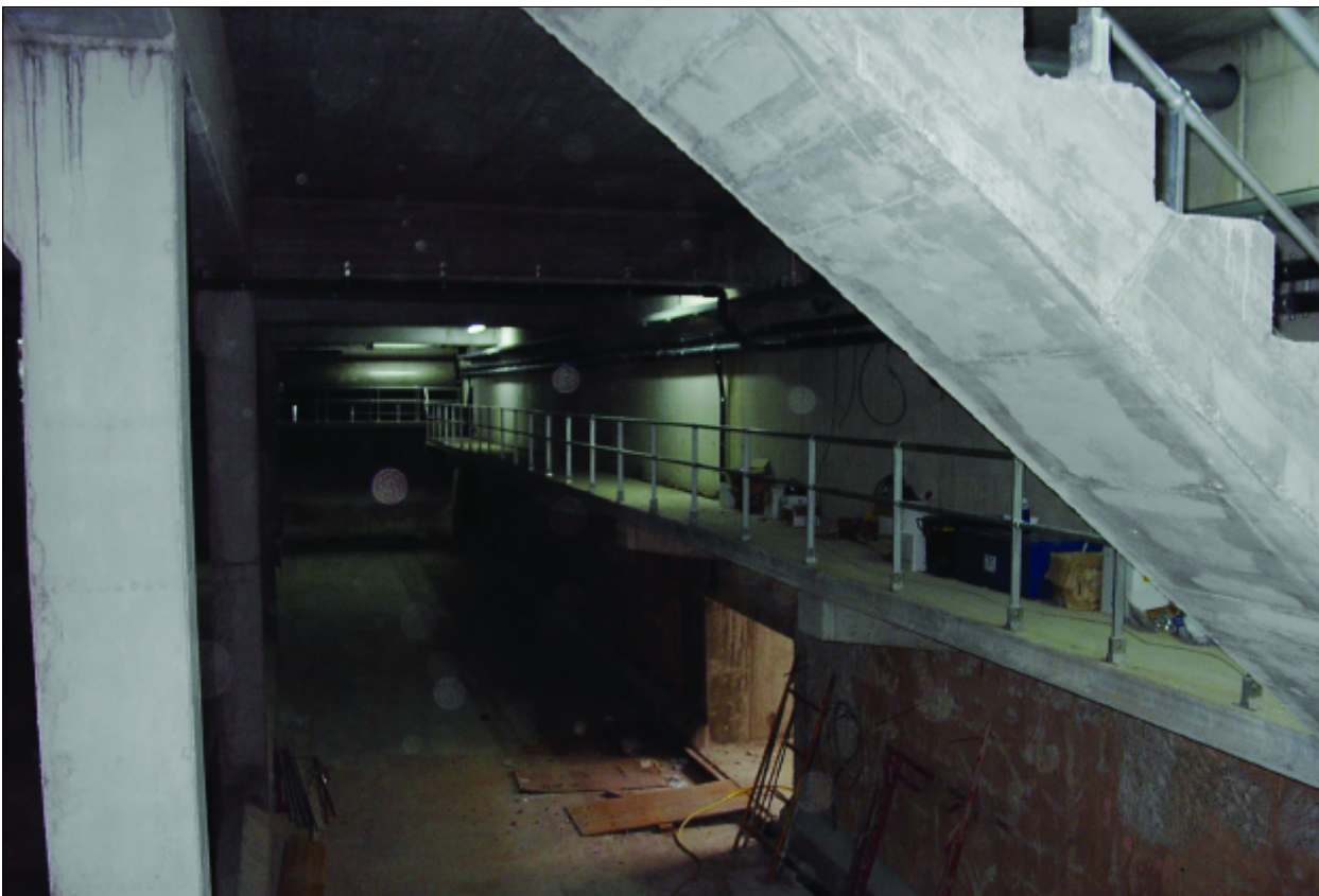
Interior del dipòsit per aigües pluvials del Camp de l'Epedrat a Cornellà. Detall de l'entrada al dipòsit per una de les càmares de dissipació. Obra proposada pel PDAP
