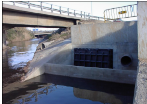
Clapeta situada al col·lector que desguasa el dipòsit de la Ciutat Esportiva Joan Gamper (en construcció). Font: TYPSA
