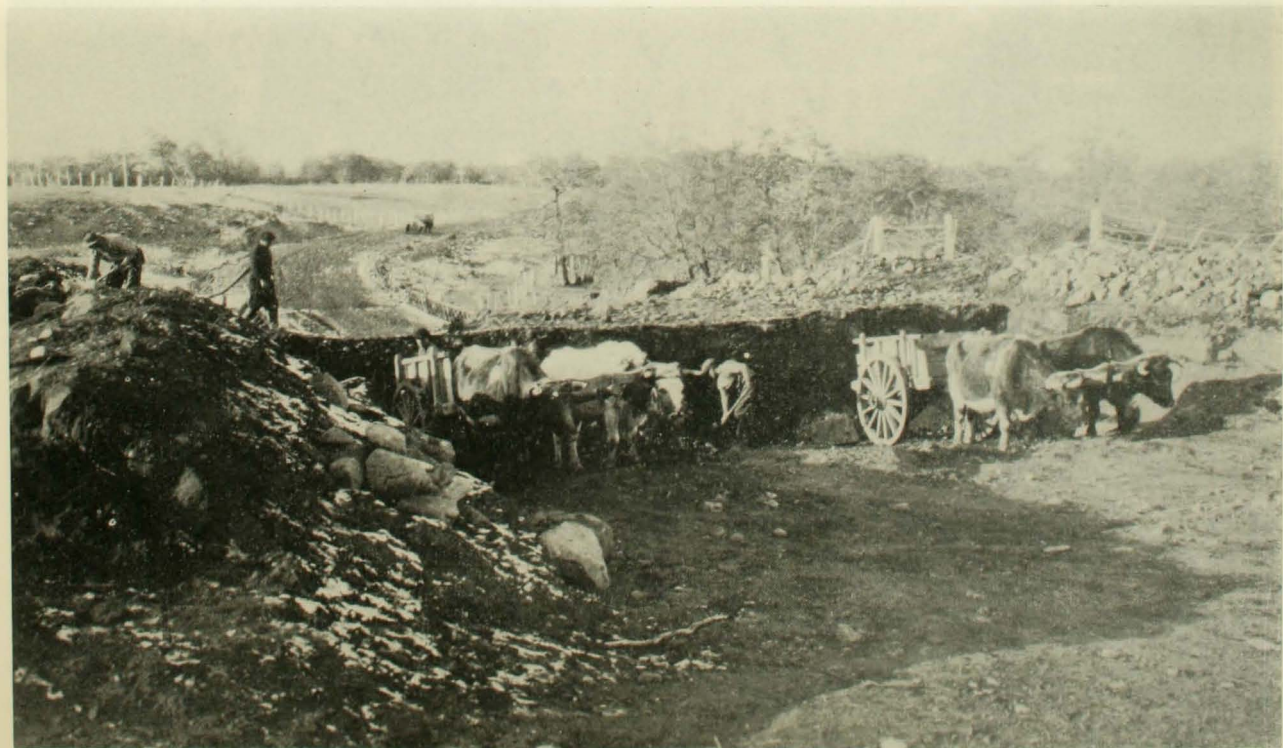
Faena de construcción caminera en el sector de Río Tranquilo (marzo de 1930).
