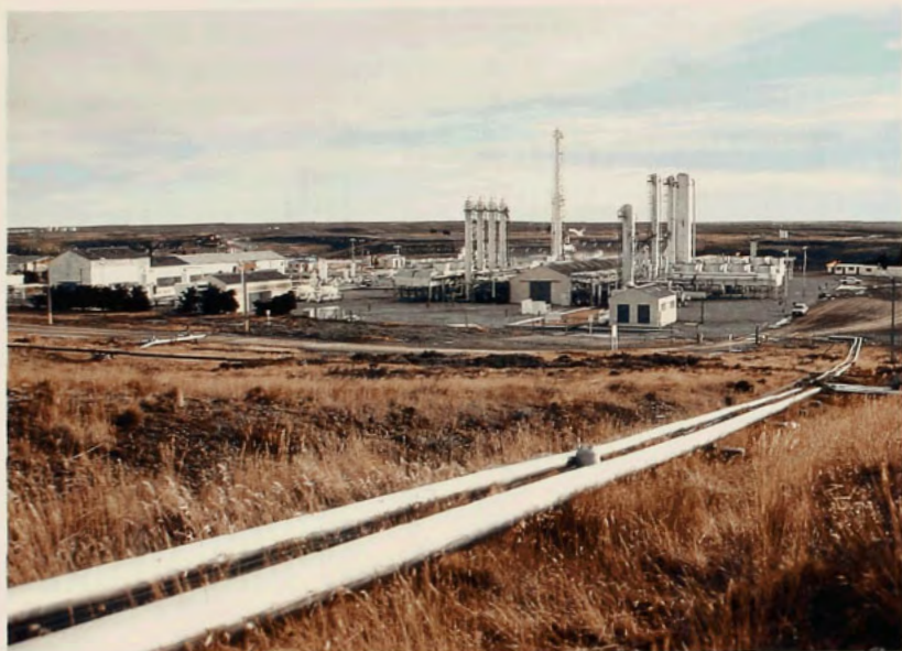
Planta de procesamiento de gases producidos en el área Isla y Costa Afuera, Cullen.
