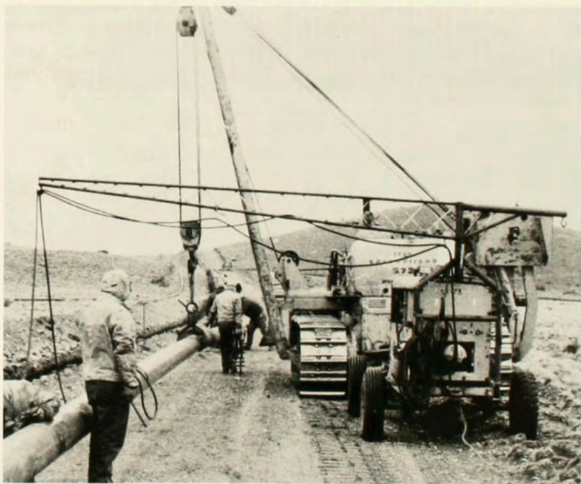
El tendido de oleoductos y gasoductos pasó a ser una labor frecuente a partir de 1950-51 una vez que comenzaron a diversificarse y a ponerse en producción los distintos yacimientos.
