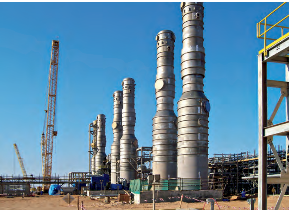
Impianto di estrazione idrocarburi in EN 1.4410 (2507); (Fonte: Aquatech)
