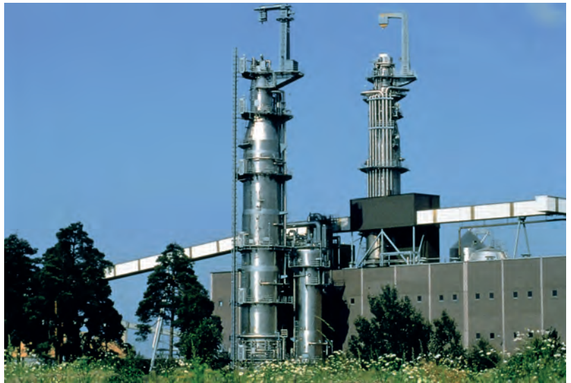
Forno continuo in EN 1.4462 (2205) per la separazione di cellulosa con solfati e torre di impregnazione, Sodra Cell Mönsterås, Svezia (Fonte: Kvaerner Pulping)
