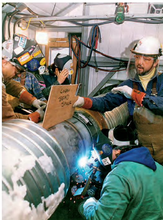
Soldadura mecanizada de una tubería de acero inoxidable dúplex de gran diámetro (Fuente: Arco Exploration and Production Technology)
