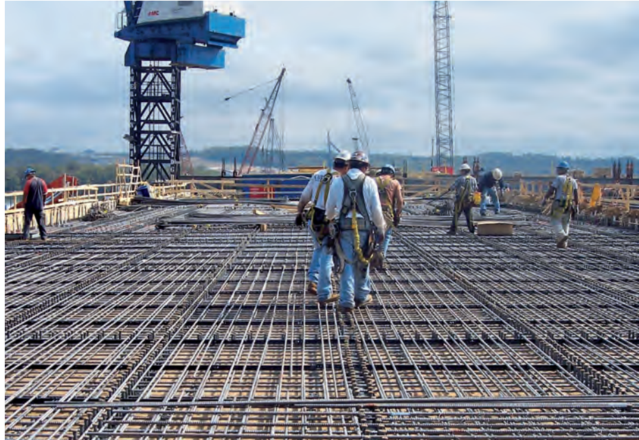
Instalación de barra de refuerzo de acero inoxidable dúplex en un tablero de puente de gran tamaño (Fuente: Hardesty & Hanover, LLP)
