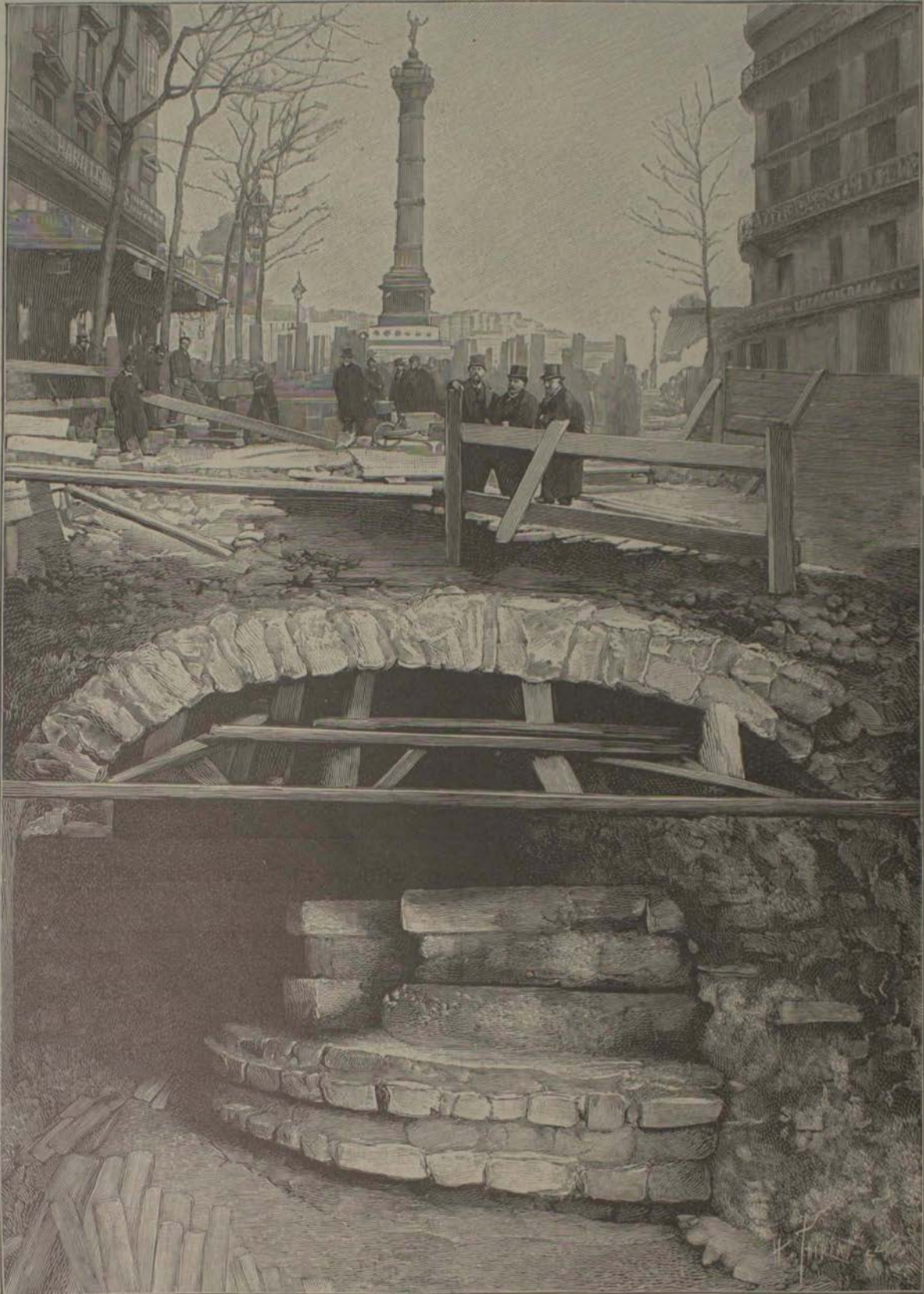
Travaux du Métropolitain : les assises de la tour de la Liberté, rue Saint-Antoine.
