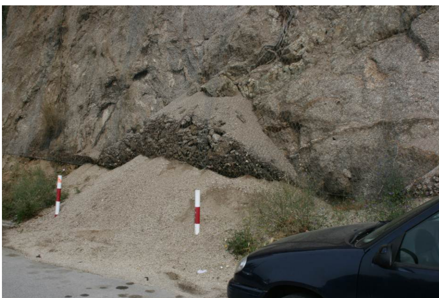
Fotografia 7. Detall de material caigut i atrapat per la malla al la base del tram A2 del talús de la Torre del Moro
