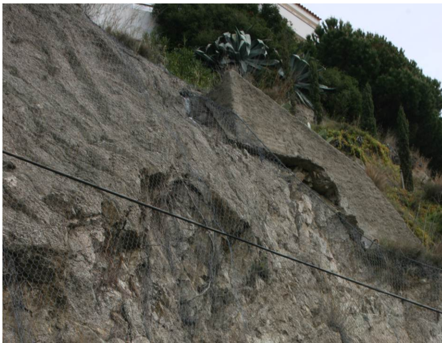
Fotografia 8. Detall de part del mur descalçat del tram A2 del talús de la Torre del Moro.
