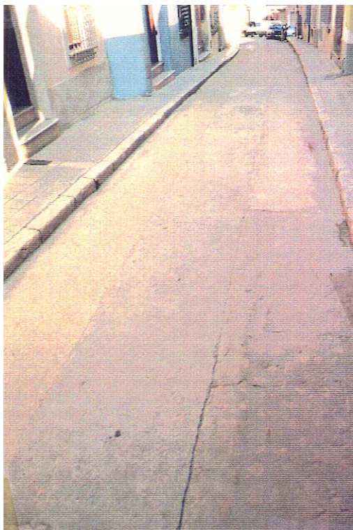
- Visualització de les etapes de pavimentació al carrer del Tossal als anys 80: roderes, primer i centre després.-
