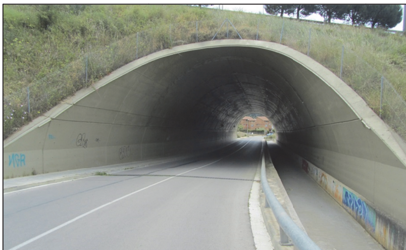
Figura 90. Segon tram canalitzat del rial de Can Figuerola, al seu pas per sota l'autopista C-32.
