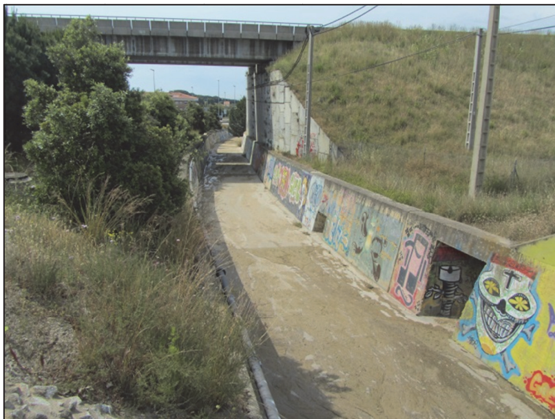
Figura 84. Canalització del rial de Cal Misser al seu pas per sota l'autopista C-32.
