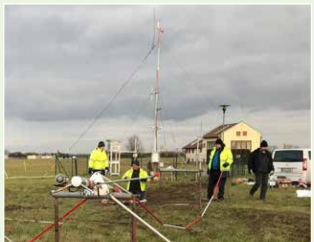
Instalace systému AWOS na pracovišti radiosondážní skupiny v Prostějově (2018)
