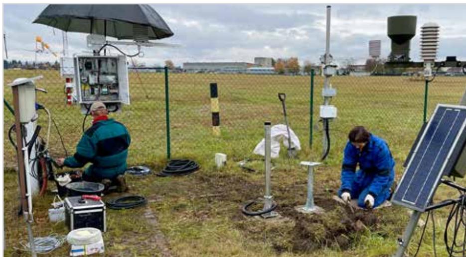
Obr. 31 Instalace ústředny a srážkoměru na meteorologickém měrném pozemku
