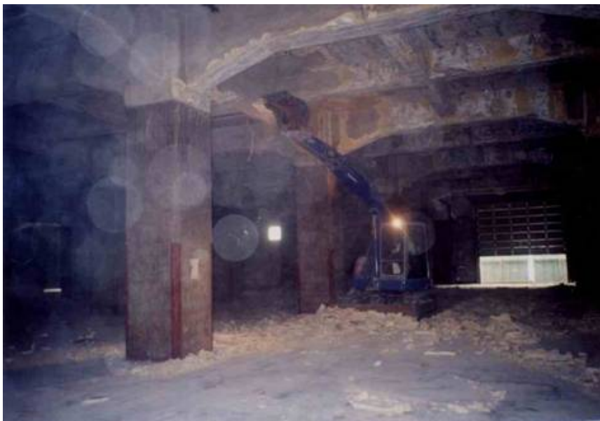
図 冷蔵倉庫におけるフロン断熱材の引き剥がしイメージ
