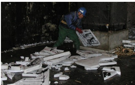
図 バールによる分離断熱材片 (XPS 後貼り)
